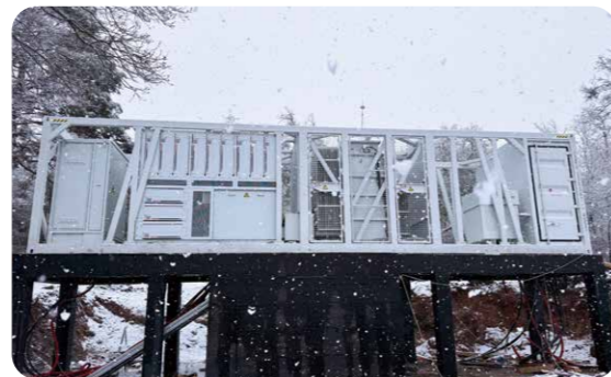
> 11.25MW/45MWh String ESS Project (Bulgaria)
