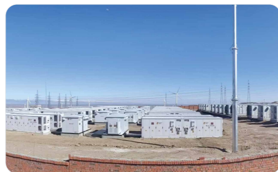
> 100MW/400MWh (Burqin, Xinjiang, China)
