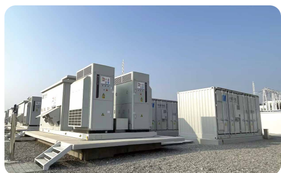
> 100MW/200MWh (Turpan, Xinjiang, China)
