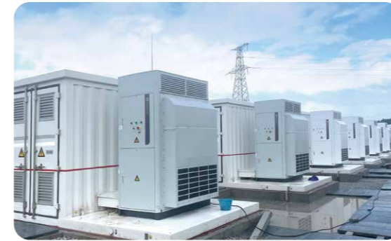
> 25MW/50MWh (Wanning, Hainan, China)
