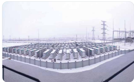
> 154MW/308MWh (Jiayuguan, Gansu, China)
