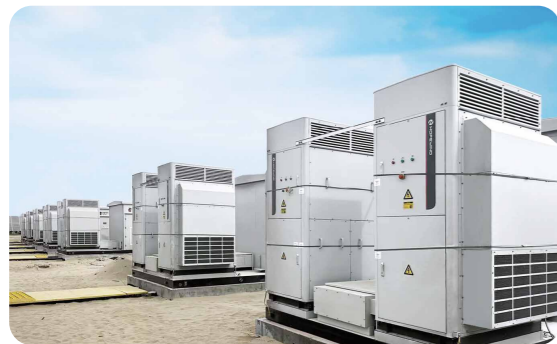
> 50MW/100MWh grid-forming (Kashgar, Xinjiang, China)
