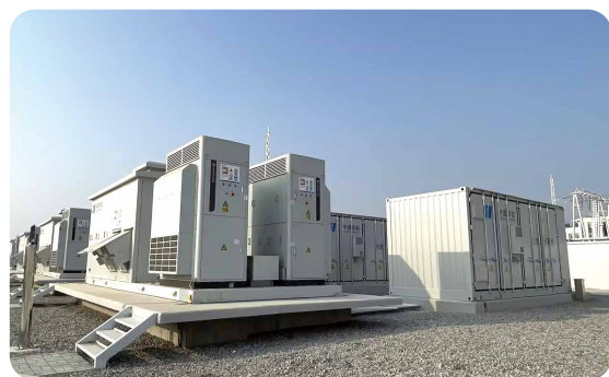
> 100MW/200MWh (Turpan, Xinjiang, China)
