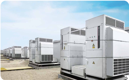
> 50MW/100MWh grid-forming (Kashgar, Xinjiang, China)
