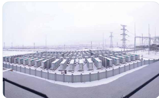
> 154MW/308MWh (Jiayuguan, Gansu, China)
